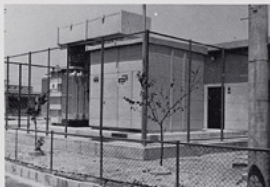
▲ 共同受電設備
