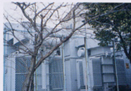
▲共同受電設備
