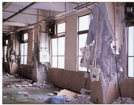
団地内の工場の被害
